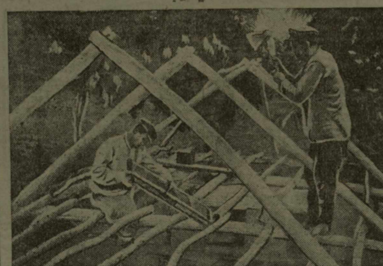
П. М. Тюнин — колхозник биновского района, Краснодарского края — спрашивает на фронте. Дома у него остались трое детей. Колхоз фронтовика и строит для них новый дом.
